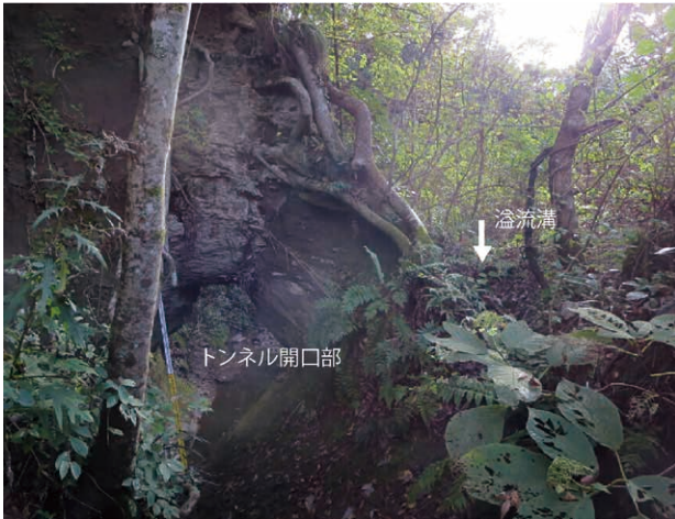
図16. トンネルDの開口部と洪水対策としての溢流溝。
