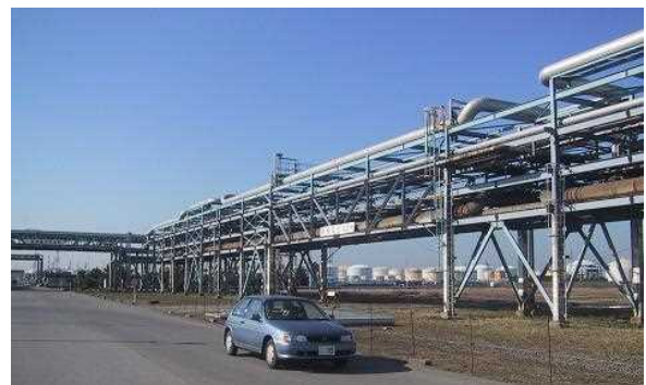
千葉製油所と千葉工場をつなぐパイプライン
